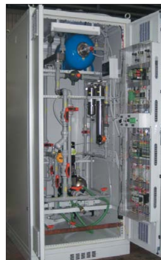
Система водяного охлаждения
